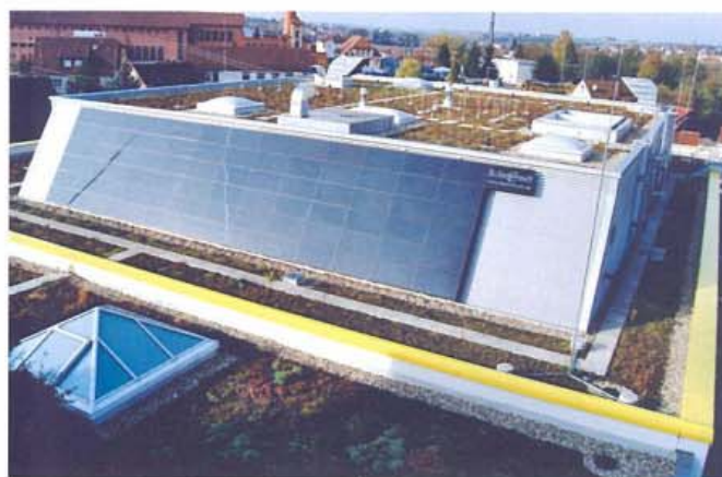
屋上に設置された太陽光発電システム。周りは緑化されている。
