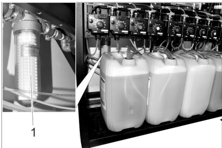
1 Filtre de la pompe antigel
