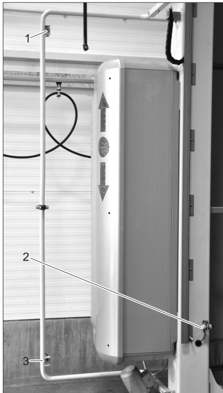
Bild 2 1 Ljusbarriär position 2 uppe 2 Gränsställare takborste nere (DBU) 3 Ljusbarriär position 2 nere
