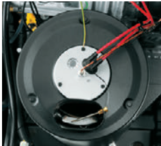
排ガス温度モニター
