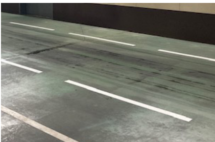
床の汚れが取り切れておらず 自動搬送設備の不具合が発生する恐れがある
