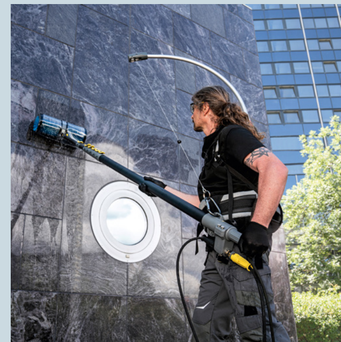
DAS TRAGESYSTEM reduziert die erforderliche Haltekraft beim Arbeiten mit den einzelnen Systemkomponenten der Fassadenreinigung.
