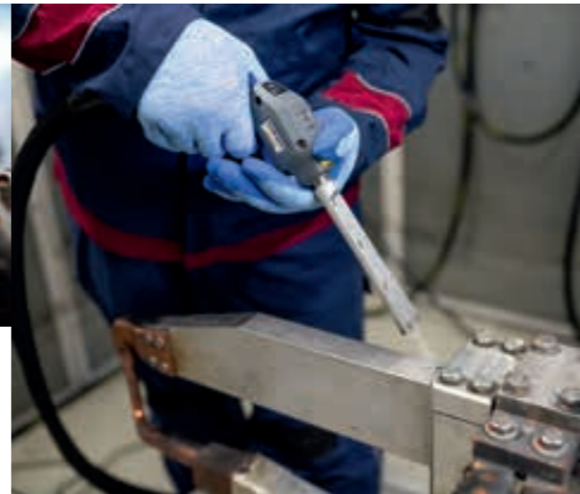
Avant les travaux de maintenance, le nettoyage est effectué sur place, rapidement et en douceur, avec de la neige carbonique.
