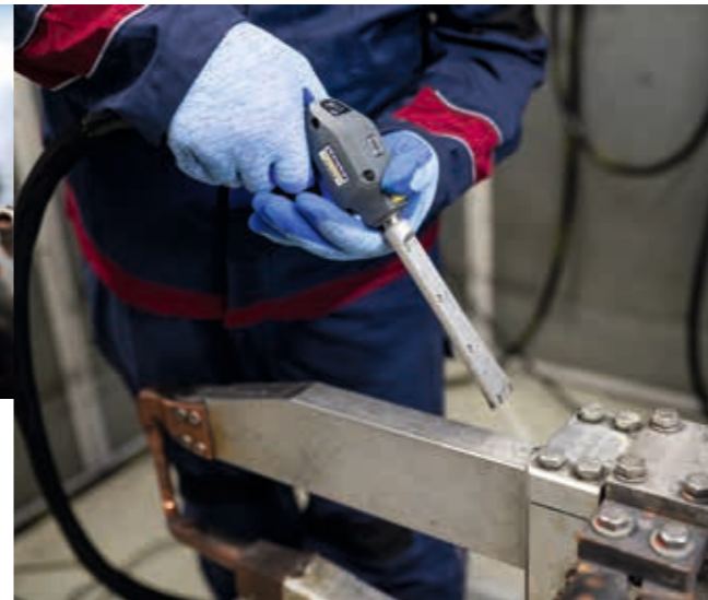
Antes de los trabajos de mantenimiento se limpia con hielo seco de forma cuidadosa, rápida e in situ.
