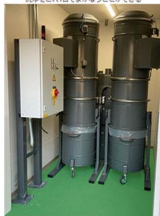
【写真2】産業用バキュームクリーナーと配管を組み合わせたセントラルバキュームシステム
