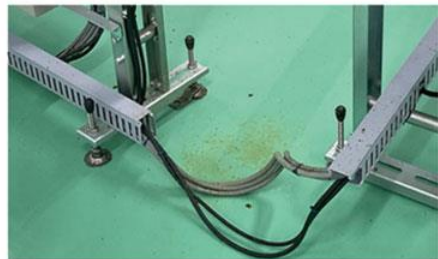
【写真3】床には粉末類や油などが落ちてしまうため、毎日、これらの汚れを取り切らないといけない
