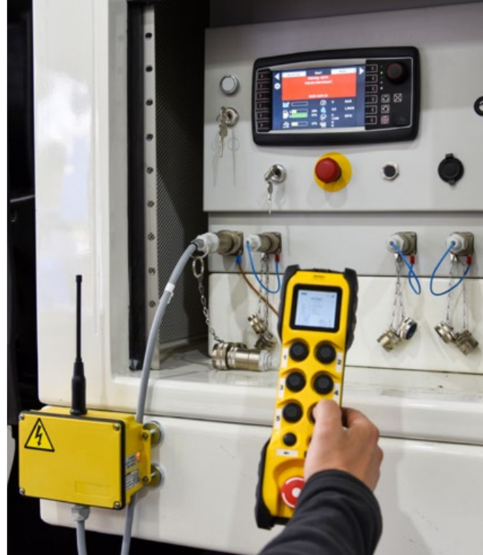
Angeschlossener Transceiver am Schaltschrank
