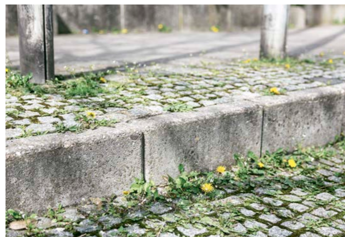
Vorher Starker Bewuchs mit Gräsern, Moosen und Löwenzahn zwischen den Fugen des Kopfsteinpflasters.
